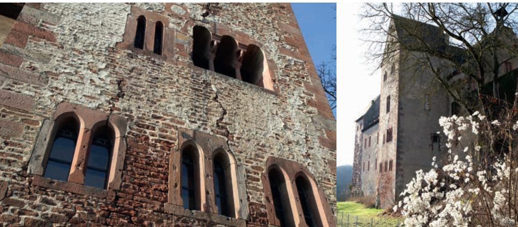
Links: Spalte im Ostturm. Rechts: Mainseite des Ostpalas.
